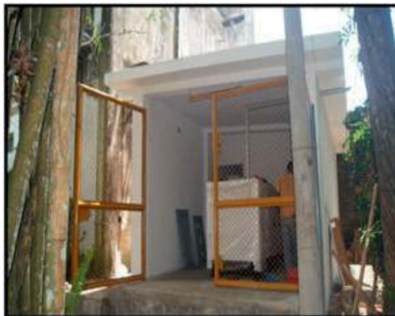
Imagen 135: Casa de fuerza del Centro de Alto Rendimiento Computacional de la Amazonía Peruana.
