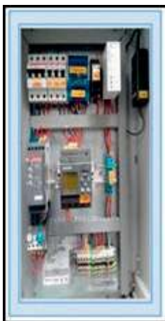
Imagen 72: Tablero de transferencia automática. Créditos: Elaboración propia
