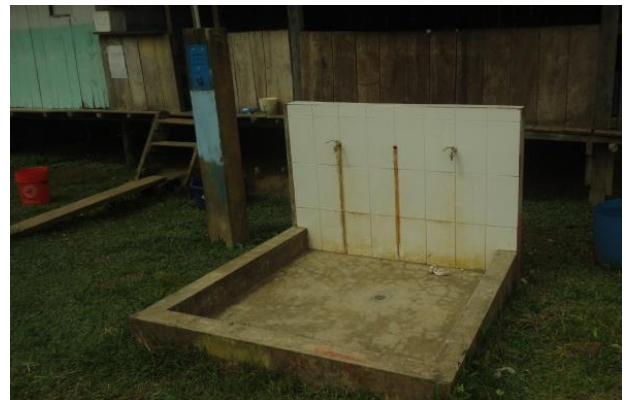
Pileta de abastecimiento de agua
